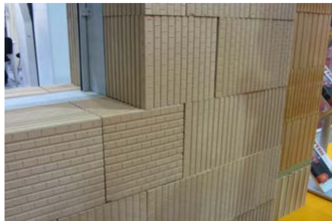
Nevhodné umístění ležaté tvarovky K nebo K/2 ve zdivu. Ležaté tvarovky musí končit s úrovní ostění. Jinak může dojít k jejímu poškození.
