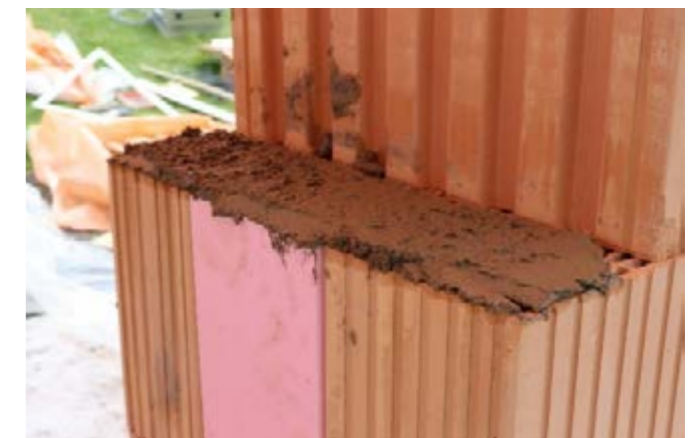
Nesprávné podmaltování překladu před jeho osazením. V místě tepelného izolantu (EPS, XPS...) nesmí být malta.
